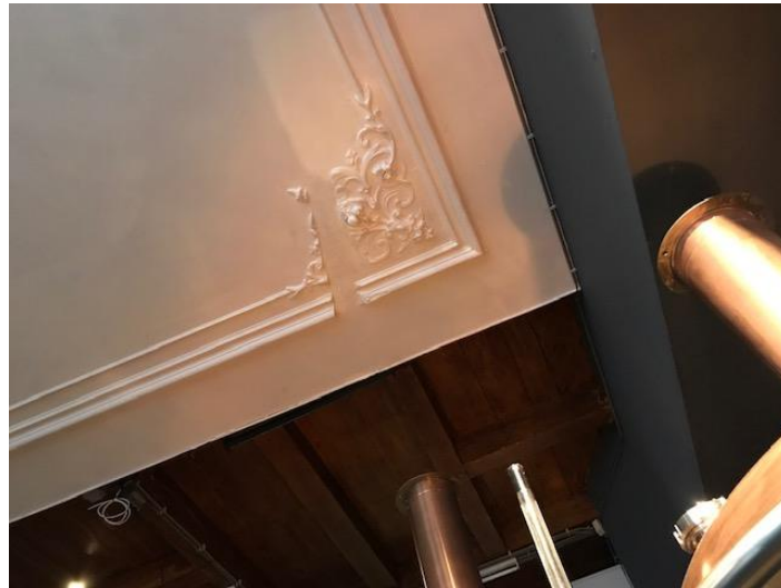
Stucplafond aangetast door (inmiddels verwijderde) elektraleiding, Burgwal 45
