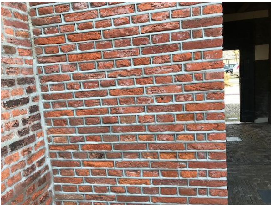
voorbeeld van een te hard gevoegde muur waardoor de steen is aangetast, bovendien is hier voor een foutief voegtype gekozen. Paardenmarkt
